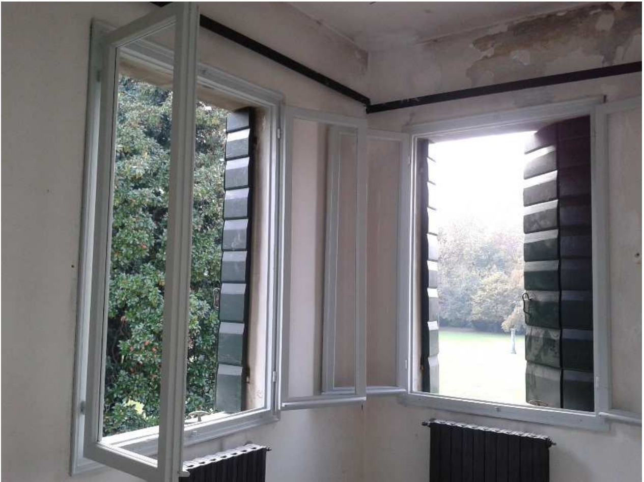
degrado delle pareti al piano primo interessate da umidità
