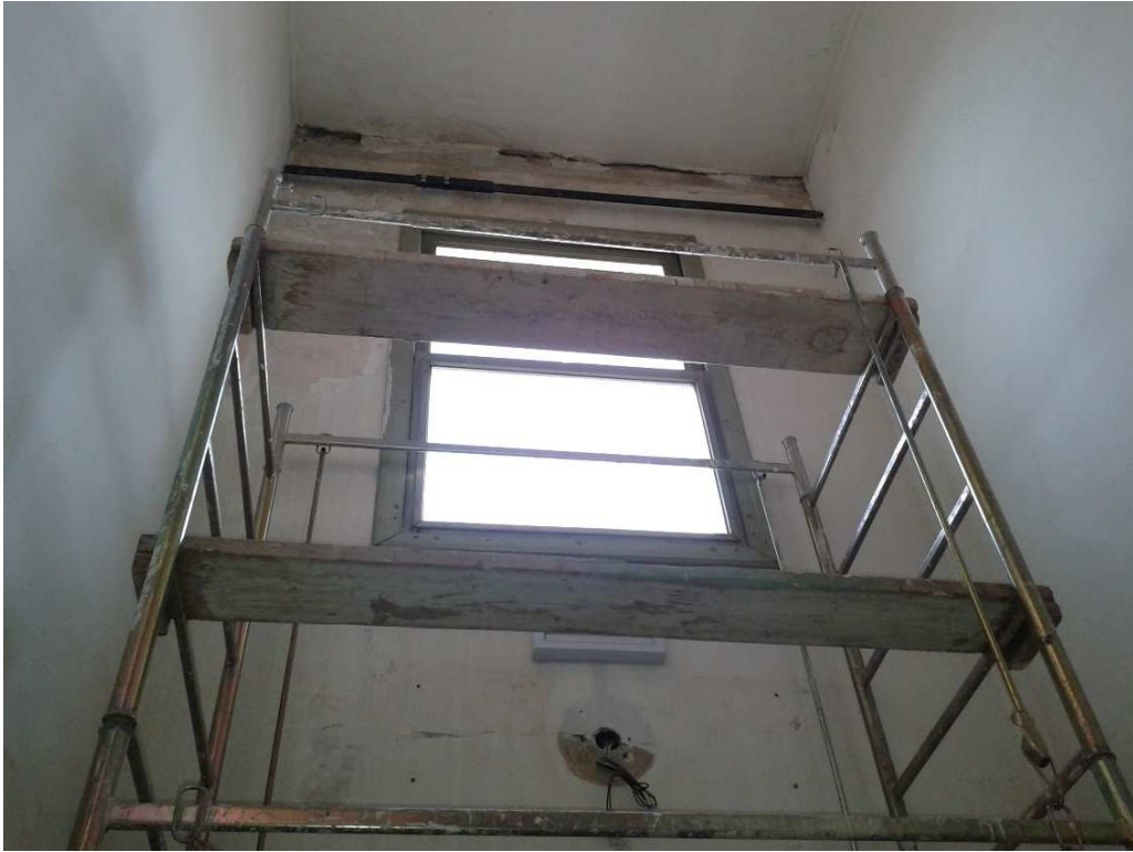
degrado delle pareti interessate da umidità
