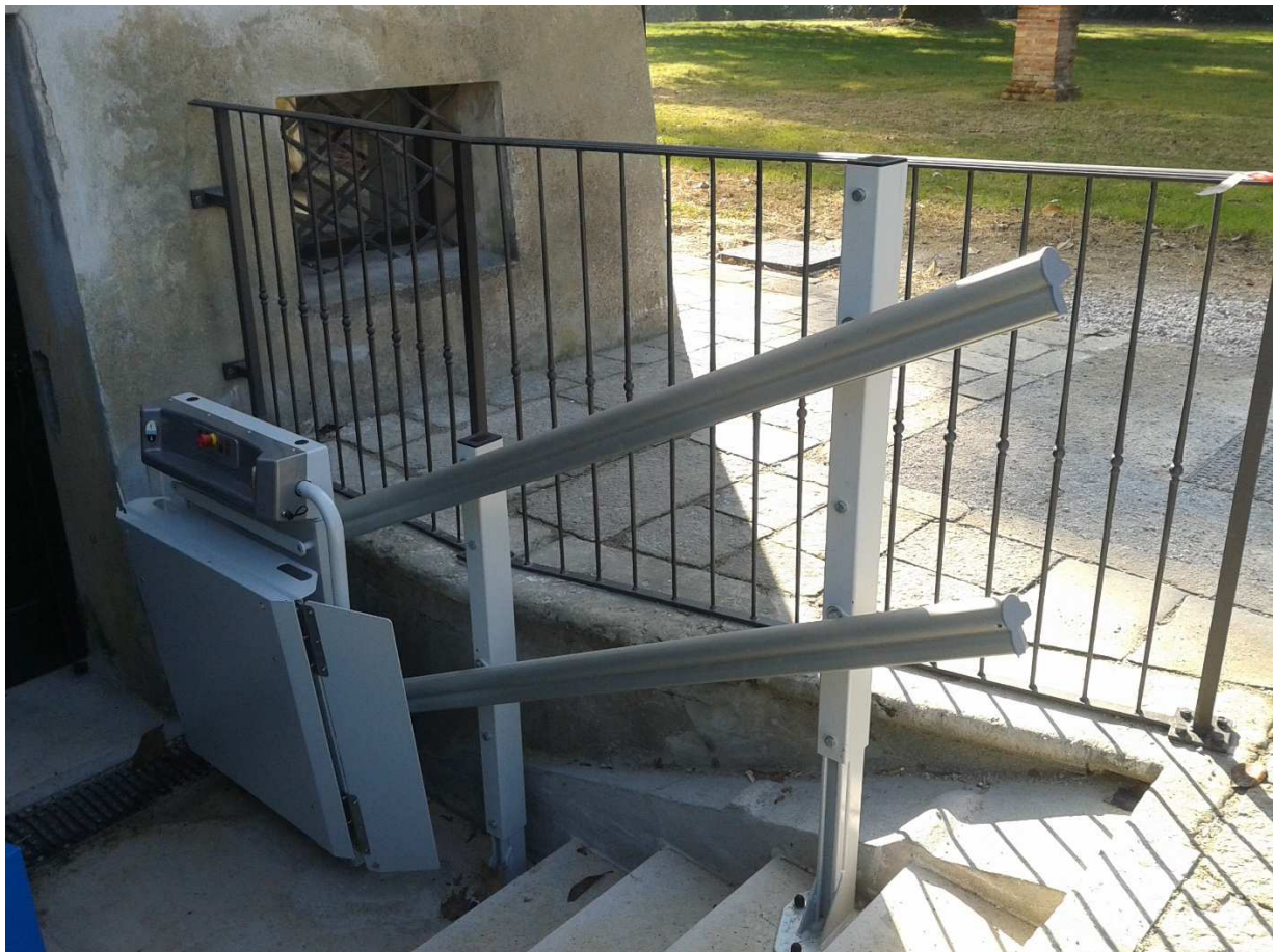
parapetti metallici e impianto servoscala per accesso ai servizi igienici
